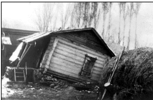
Рис. 3.4. Перекос деревянного дома
